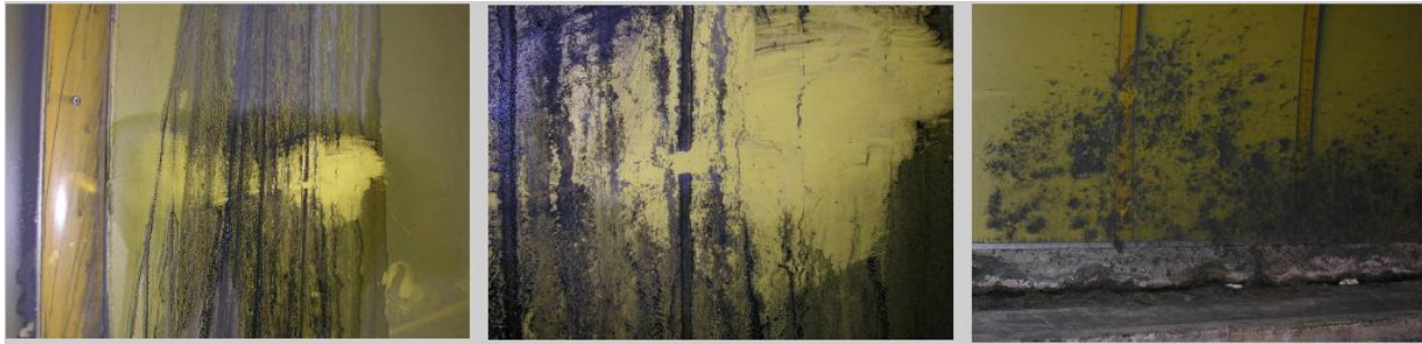
Efecto de las filtraciones de agua meteórica con deposito calcáreo
